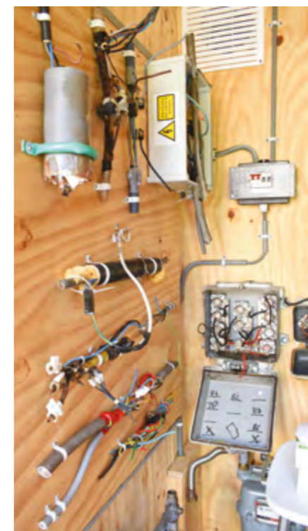
Hennepkwekers knoeien vaak met elektriciteit. Dit levert brandgevaar op voor omwonenden.
